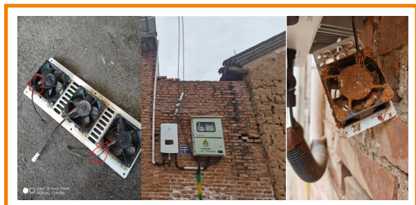
Figura 2: Roedor morde o cabo do ventilador e a areia fica presa no ventilador
