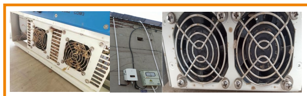
Figura 3: Detritos bloqueiam os dutos de ar e ventiladores do inversor, causando falha no inversor
