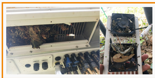
Figura 1: O acúmulo de folhas caídas bloqueia os dutos de ar de refrigeração e os ventiladores
