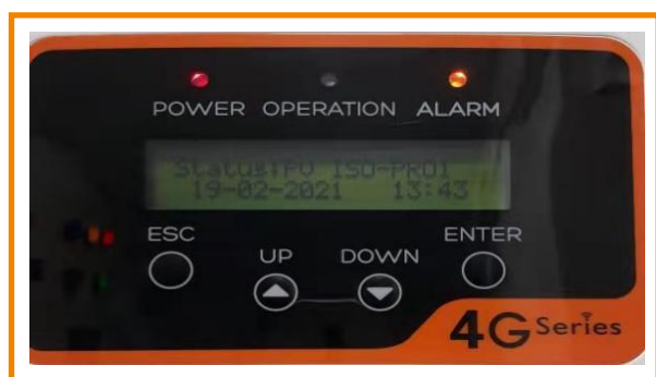
Figure 5 : Le système PV a un problème de faible impédance
