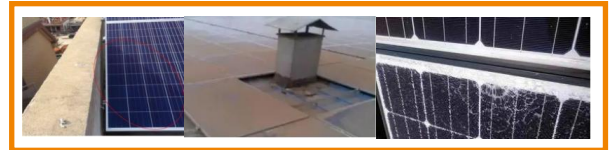
Figura 4: Occlusione e danneggiamento del pannello fotovoltaico
