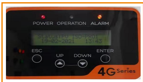
Figura 5: L'impianto fotovoltaico presenta un problema di bassa impedenza
