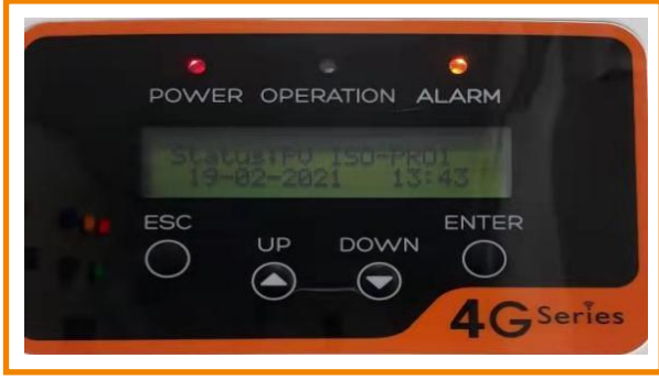
Şekil 5: Fotovoltaik sistem düşük empedans problemine sahiptir
